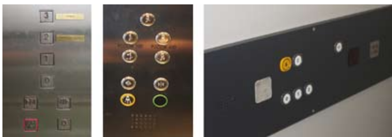
Fot.11. Rozmieszczenie przycisków na panelach sterowniczych w kabinach dźwigów osobowych: windach, prawidłowe (fot. 11a) i nieprawidłowe (fot. 11b), i rozmieszczenie prawidłowe, ale bez oznaczeń wypukłych i w brajlu (fot. 11c). Żadne z tych rozwiązań jednak nie spełnia pełnych wymogów dostępności i normy EN-PN 81-70 (zdj. M. Wysocki).
